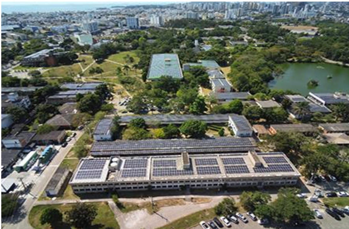
Rysunek 7 Elektrownia fotowoltaiczna na dachu
